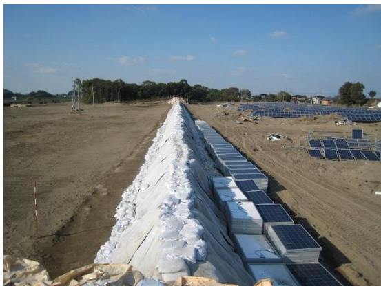
写真－11 砂丘の中央部の仮設堤防 (右側は取り外された太陽光パネル)
