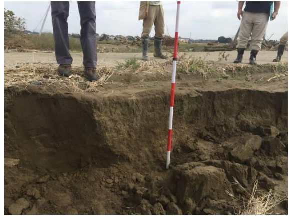
写真-4 流出跡の地盤の表層部 (県道 357 号線西側;土質はシルト質微細砂)
