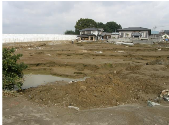
写真－2 破堤か所の洗掘状況 （地表面が凸凹，左側奥が仮設堤防）
