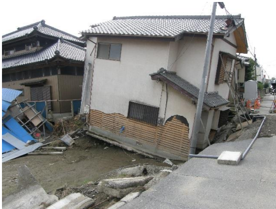
写真-5 基礎地盤が流出して沈下・傾斜した 家屋(県道 357 号線沿い)
