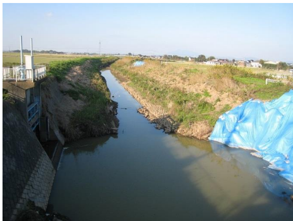
写真-15 相平橋から八間堀川の上流を望む (ブルーシートは破堤か所)
