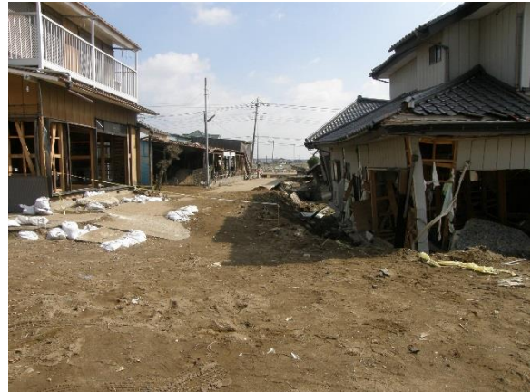
写真-6 基礎地盤が流出して沈下・傾斜した 家屋(破提か所の近傍)
