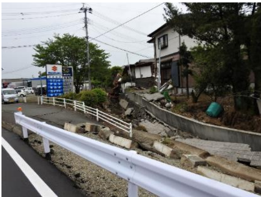
K_05：水路護岸の石積みが崩れ，敷地が押し出している。
