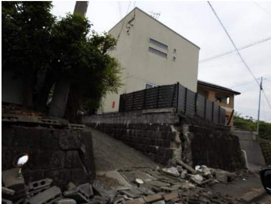
K_09：角部が破壊した擁壁。
