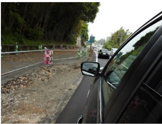
K_03：大規模避難所へのアクセス道路は，最優先で仮復旧が行われている。
