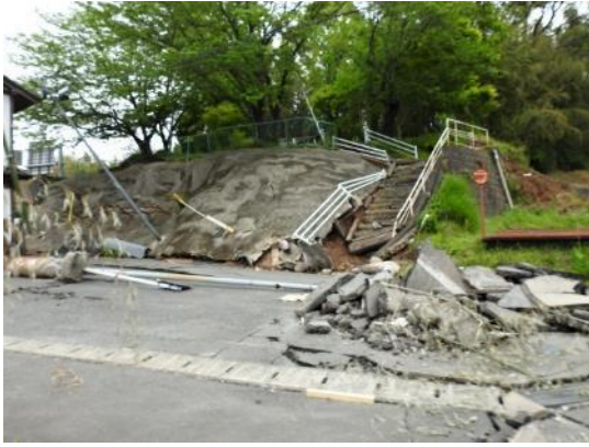
K_07：階段の僅かな盛土が崩れて、地山の吹き付け工にまで被害が及んだとみられる。
