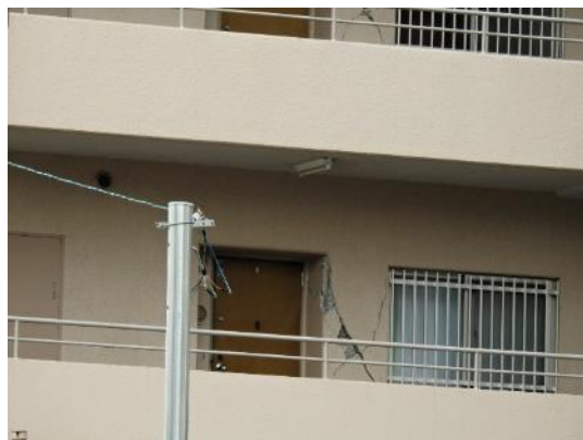
K_30：遠目には無事な建物も、よく見ると構造的な損傷があるケースも多い。
