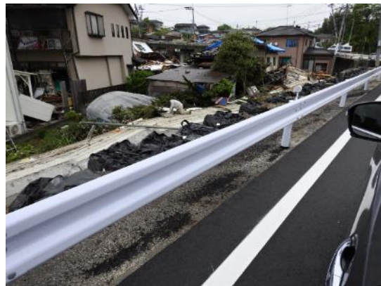
K_06：道路盛土のブロック積み擁壁が根元から倒れている。
