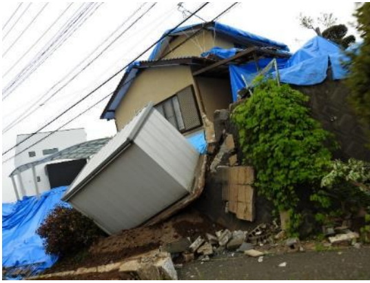
K_01：間知ブロック積擁壁が壊れて，建物が傾いている。
