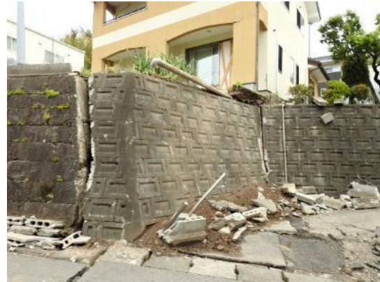
K_10：異工種の継ぎ目で破断した擁壁。家屋は完全に傾いている。
