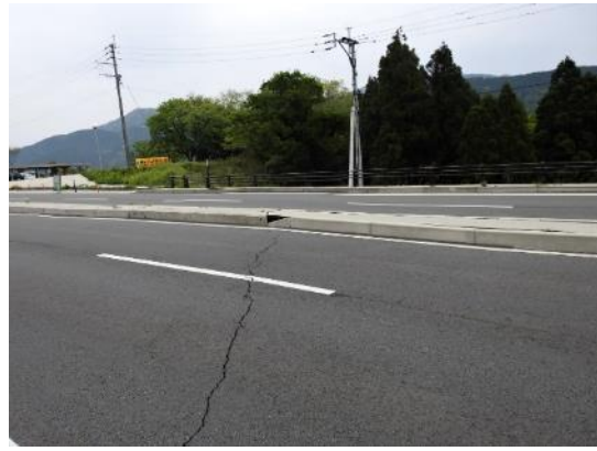
K_24 : 国道 57 号線。阿蘇に近づくと、切盛り境界の亀裂が目につくようになる。
