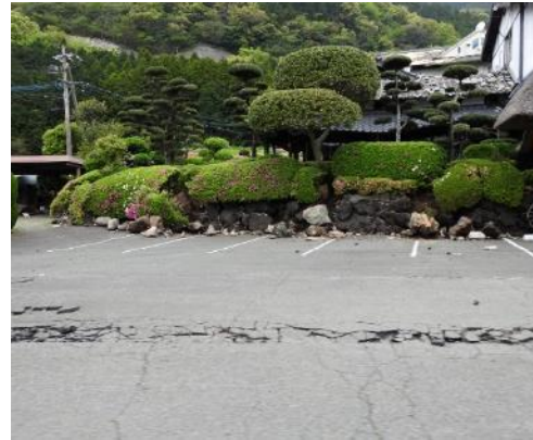
K_26 : 高さのない盛り土だが、空石積みの石が飛び出している。
