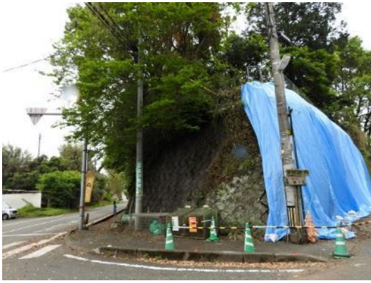
K_23 : 周辺では擁壁の損傷は少ないが、やせ尾根の保護擁壁は崩落したようである。
