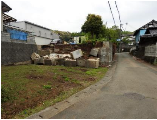
K_19: 左側の間知ブロックは損傷がないが、きちんとした擁壁構造ではないブロックは崩壊している。
