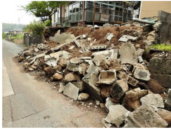
K_20: やや高めに盛っている宅地は、崩落しているところが多い印象である。
