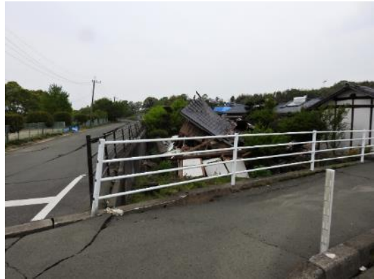
K_22: 左側の道路中央の亀裂は、やや盛り上がっている。
