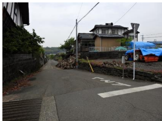
K_18 : 左岸側でも崩れている擁壁は多い。
