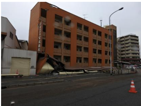
K_29：報道でも有名になったビルだが、周囲に同じような壊れ方をした建物は見られない。
