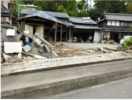
K_13 : 鉄筋の入ったブロック塀はこのようにきれいに倒れている。鉄筋が入っていない塀はバラバラに崩れている。
