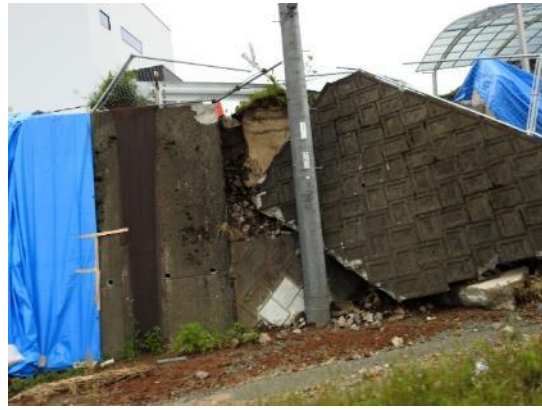
K_02：間知ブロック積擁壁が中ほどで折れた例。
