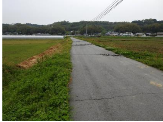
K_14 : 低地のやや右岸側（北側）。不明瞭な亀裂とともに、道や畔が 10m くらいの幅を持って横ずれしている。
