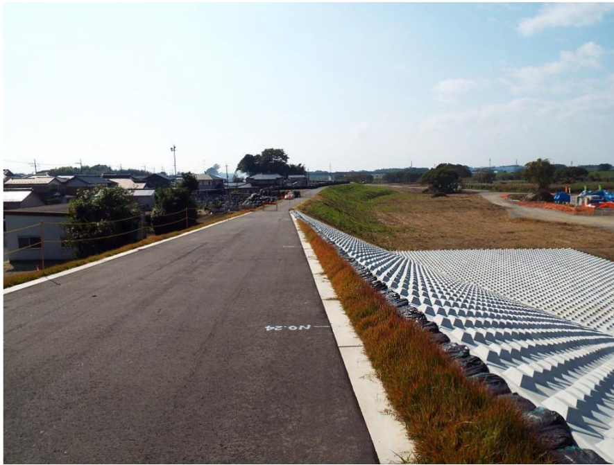
写真-2.1 堤防決壊箇所(21k 付近)の堤防左岸堤外地側法面
