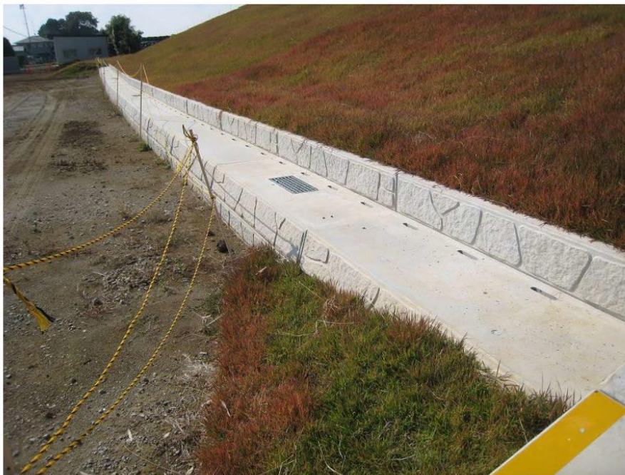
写真－2.6 堤防決壊箇所(21k 付近)の左岸堤防堤内地法尻部
