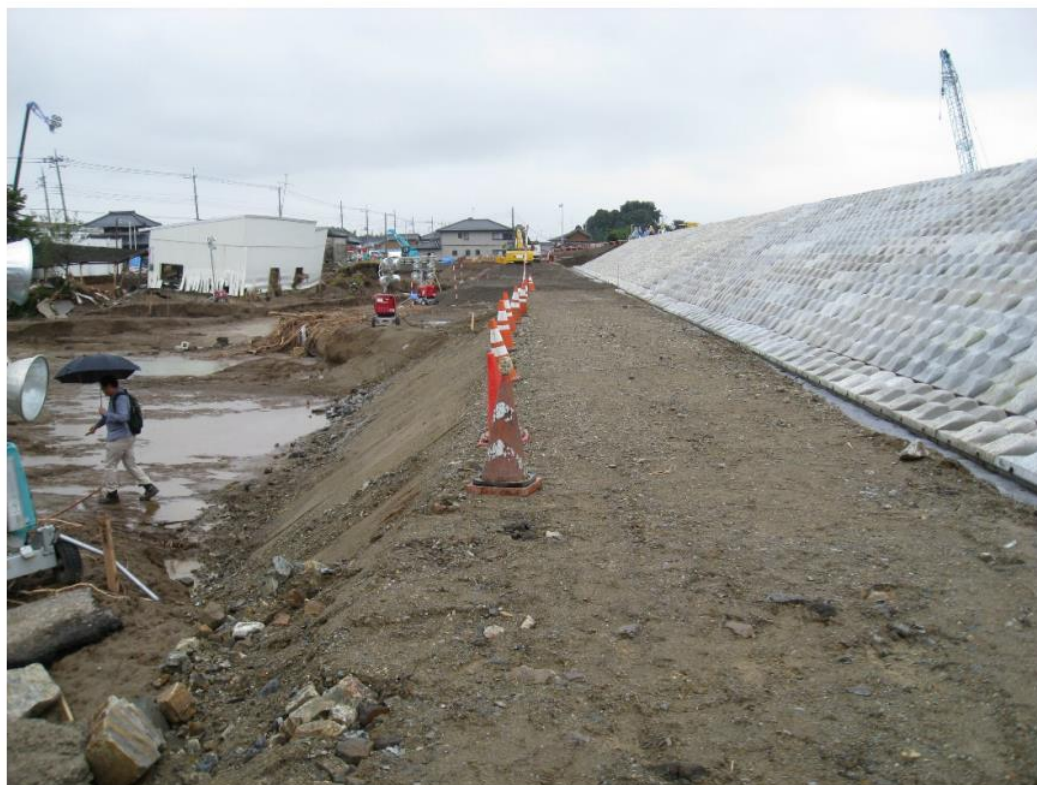
写真-2.5 堤防決壊箇所(21k 付近)の左岸堤防堤内地法面 (2015年9月18日撮影)
