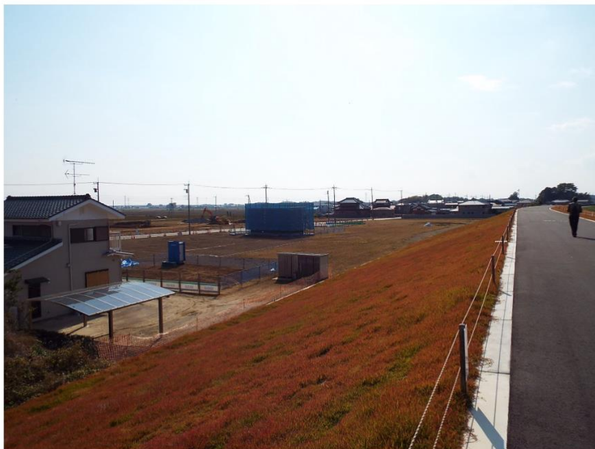
写真-2.4 堤防決壊箇所(21k 付近)の左岸堤防堤内地法面
