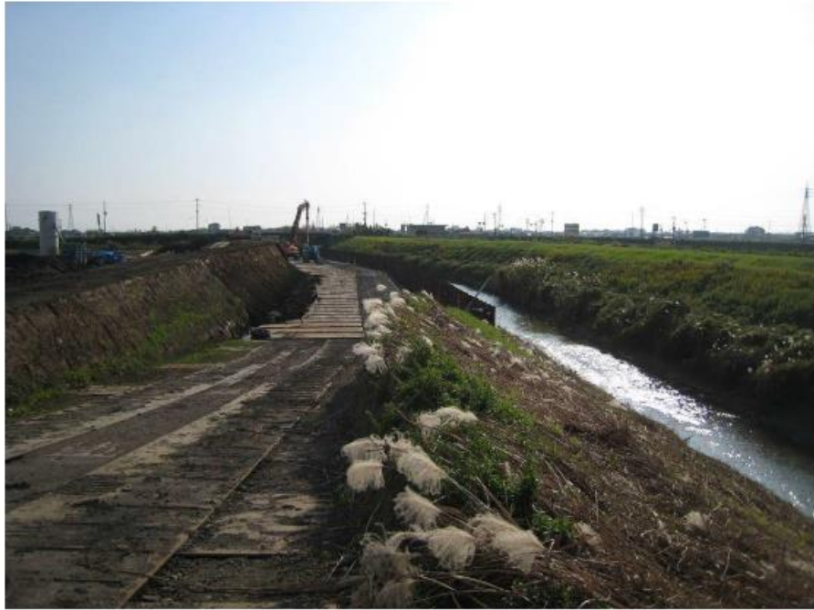
写真－4.2 八間堀川左岸決壊箇所の決壊箇所の改修工事現場（上流から撮影）
